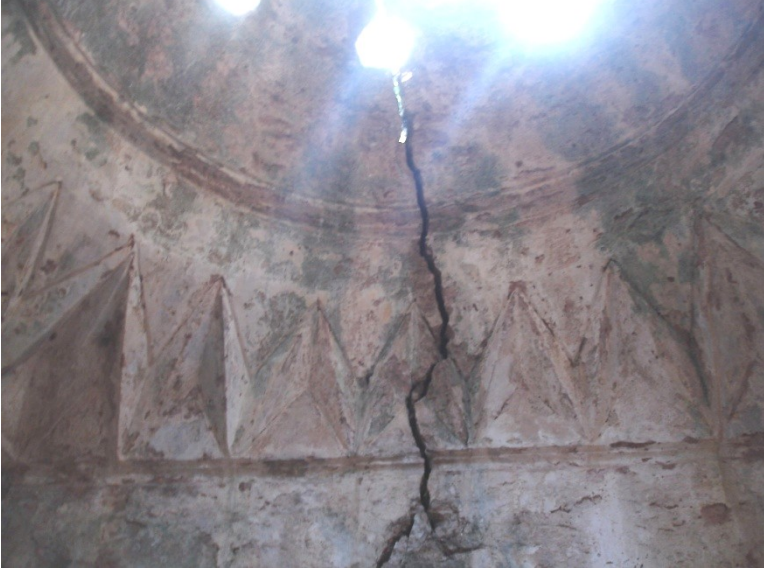
Fotoğraf 13. Urla Kamanlı Hamamı. Halvet Örtüsündeki Strüktürel Çatlak.
