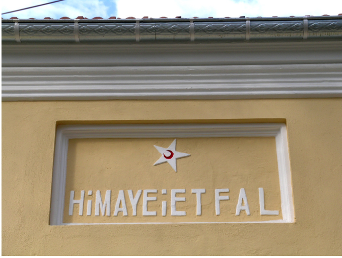
Fotoğraf 19- Himaye-i Etfal Kahvehanesi, güney cephede bulunan yazı panosu ve saçak silmesi. Onarım sonrası.
