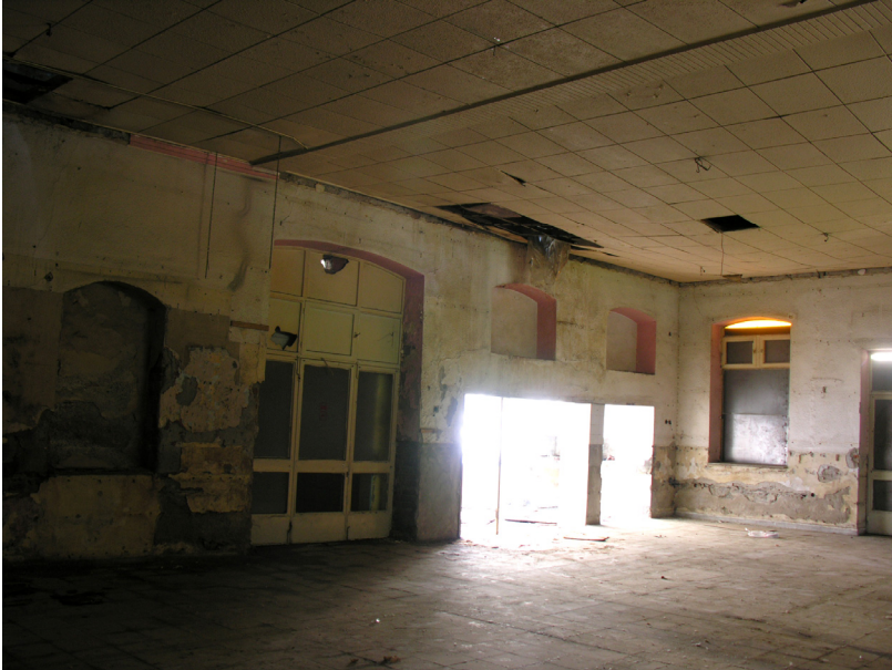
Fotoğraf 15- Himaye-i Etfal Kahvehanesi, kuzey cephenin doğusunda bulunan pencerelerin açıklığa dönüştürülmüş hali. Onarım öncesi.
