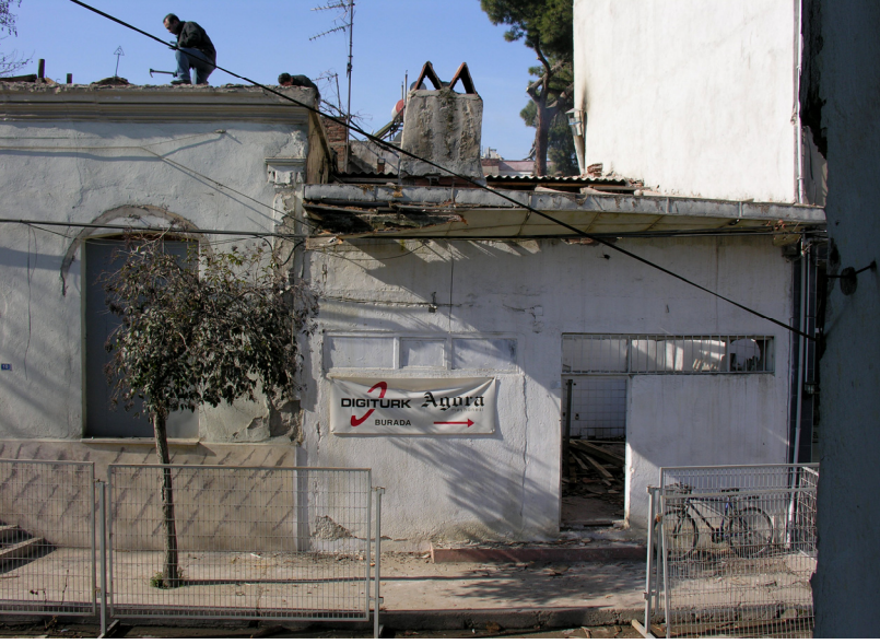
Fotoğraf 14- Himaye-i Etfal Kahvehanesi, kuzey cepheye inşa edilmiş betonarme eklenti. Onarım öncesi.
