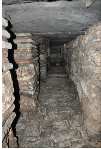
Fot. 47. Kum Kasrı Hamamı'nın cehennemlik katındaki sıcak su buharının dolaştığı kanallardan bir görünüm
