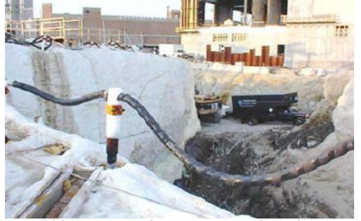
Şekil 11. Zemin Dondurma Yöntemi Uygulama Alanı. (foam-tech,2008)
