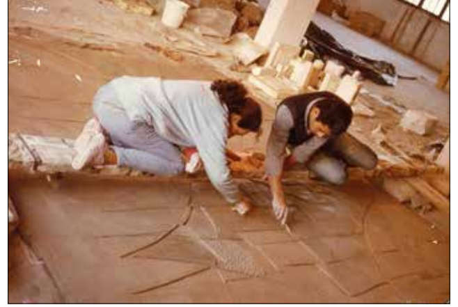
Fotoğraf 6: Uluğ ve okulundan bir öğrenci seramik panoyu üretirken (Sühendan Uluğ Arşivi, 1984) / Uluğ and a student from her school during the process of ceramic panel production (Sühendan Uluğ Archive, 1984).
