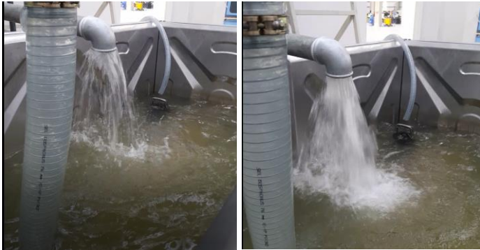
Şekil 8. Firma pompasının düşük ve yüksek debilerde çalışmasının anlık görüntüsü
