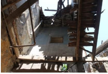
Resim 29: Yıkılan oda, içten görünüş
