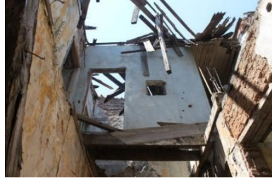
Resim 30: Yıkılan oda, dıştan görünüş
