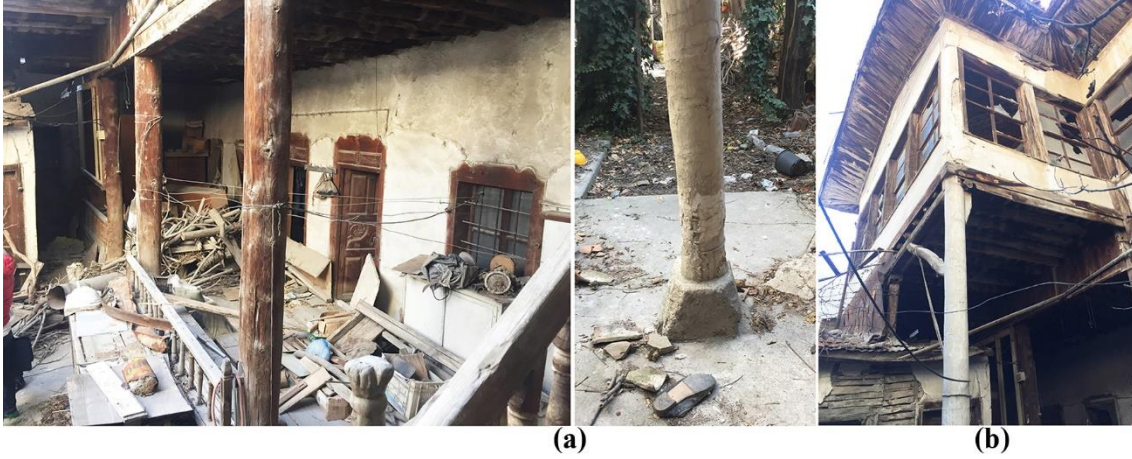
Şekil 18. (a) Kuzey cephede ahşap dikmeler ve oturtulduğu taş kaideler; (b) çıkma altı bakkal tavan döşemesi (Kaynak: Esra Büyükemir Karagöz kişisel arşivi).
