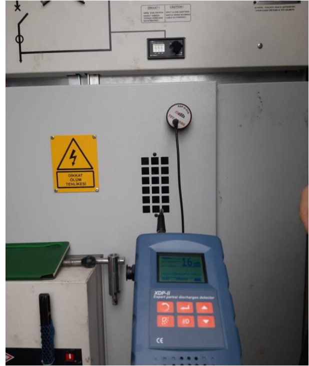
Şekil 6. Metal muhafazalı orta gerilim hücrelerinde TEV sensörü ile kısmi deşarj ölçümü (Partial discharge measurement using TEV sensor in medium voltage metal-clad cubicle)
