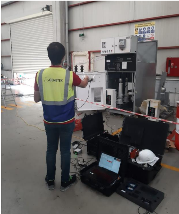
Şekil 8. Metal muhafazalı orta gerilim hücrelerinde parabolik algılayıcı ile kısmi deşarj ölçümü (Partial discharge measurement using airborne sensor in medium voltage metal-clad cubicle)
