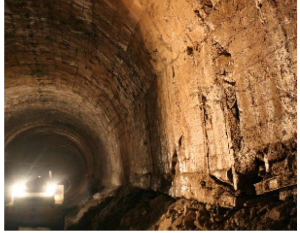
Şekil 9: Ön kaplama betonundaki çatlak (km 6+157 sol yan) Figure 9: Crack in the pre-coating concrete (km 6+157 left side)
