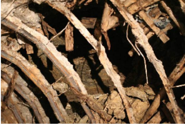
Şekil 12: Yan duvardaki kaplama betonu kaldırılınca oluşan güncel karstlaşmanın bir bölümü (km 6+157 ±4m).
