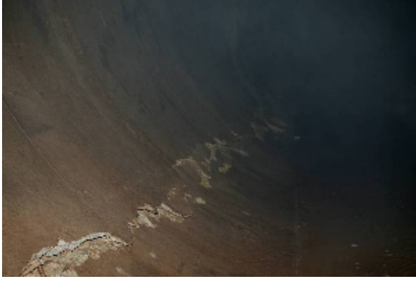
Şekil 7: Kemer betonu ile su tutucu arasında meydana gelen çatlak (km 6+125 sol yan). Figure 7: Cracks occurred between the arch concrete and waterbars (km 6+125 left side).
