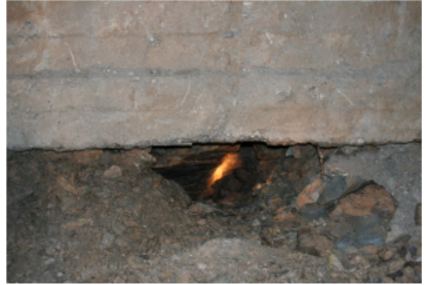
Şekil 10: Km 6+150'deki kiriş betonu altında oluşan boşluk Figure 10: Karstification under the girder concrete in km 6+150.
