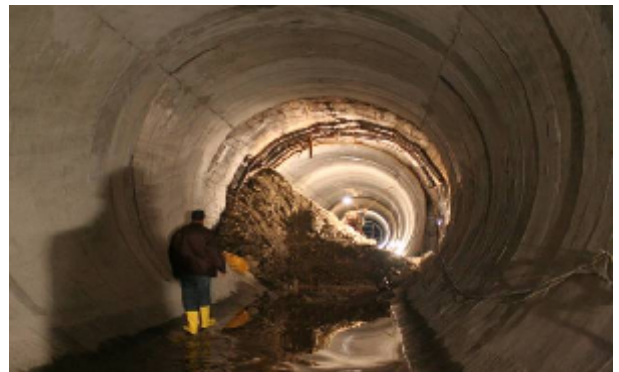
Şekil 11: Ön kaplama betonu kaldırılınca oluşan göçük (km 6+157 ±4m). Figure 11: Collapse occurred after the removal of the pre-coating concrete (km 6+157 ±4m)
