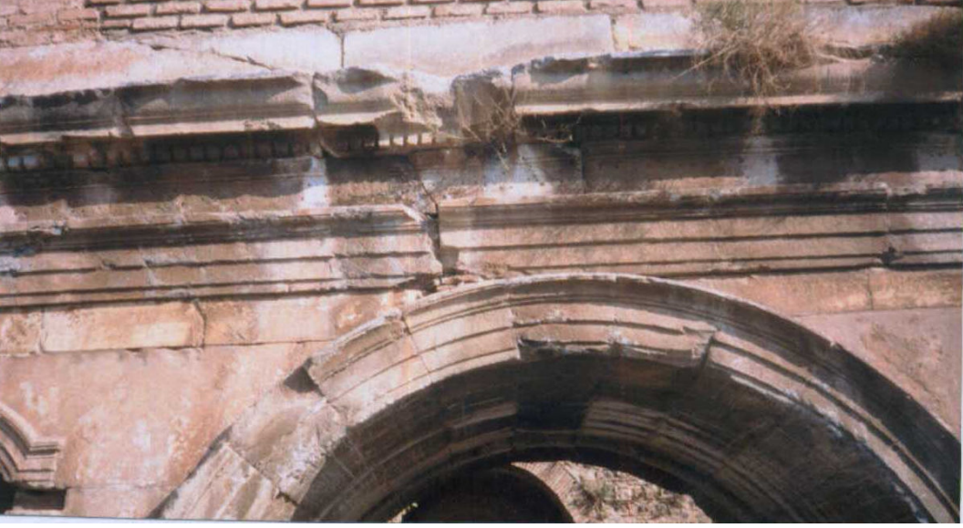
Fotoğraf 2: İznik'in giriş kapılarından İstanbul Kapı'daki deformasyon izleri (Adatepe Arşivi). Photograph 2: Traces of deformation in Istanbul Gate, one of the entrance gates of Iznik.
