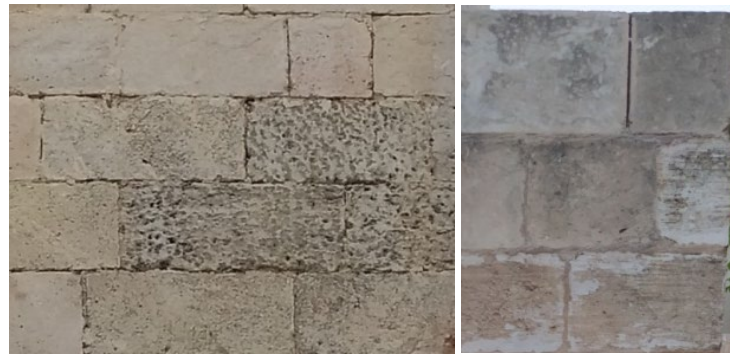
Şekil 17. Derz boşalması kaynaklı bozunmalar
