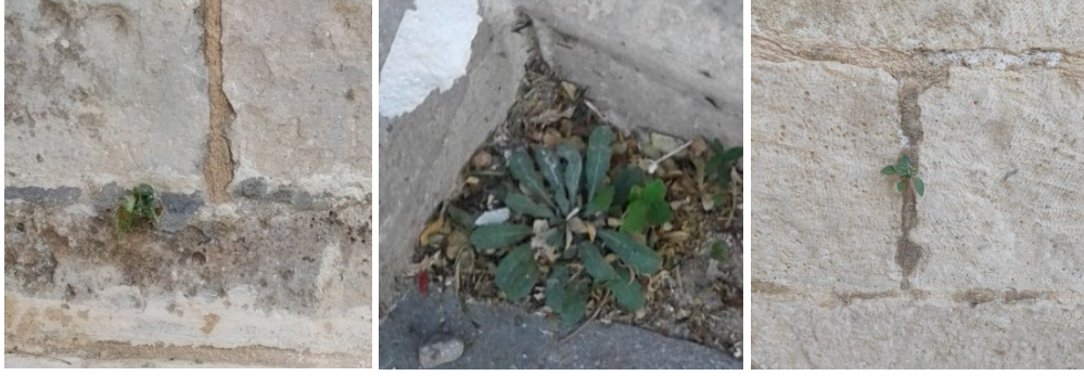
Şekil 21. Bitki oluşumu kaynaklı bozunmalar
