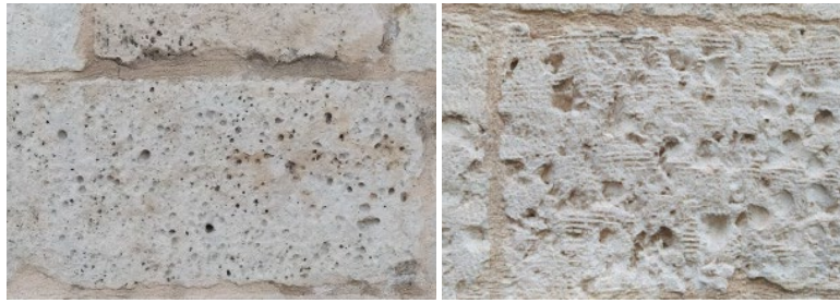
Şekil 14. Oyuklanma oluşumundan kaynaklı bozunmalar
