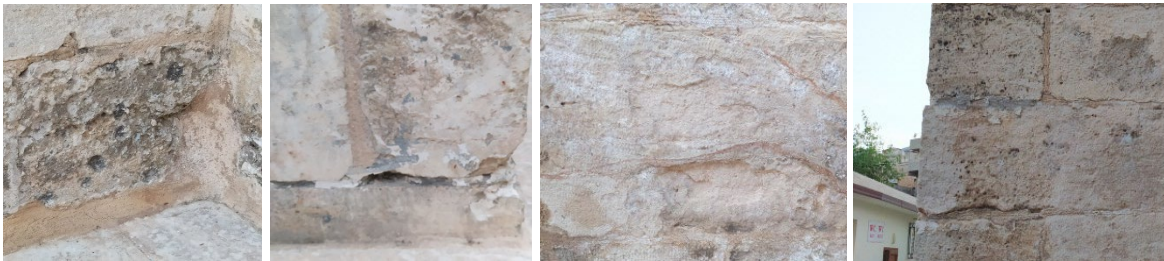
Şekil 15. Yüzey kaybı kaynaklı bozunmalar
