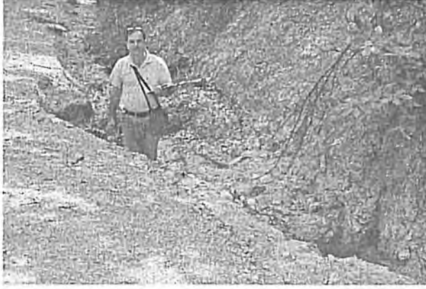
Figure 8. Deformation at ditches and lost of pavement materials (Photo: T.Ozturk) Şekil 8. Üstyapı materyalinin kaybı ve hendeklerdeki deformasyon
