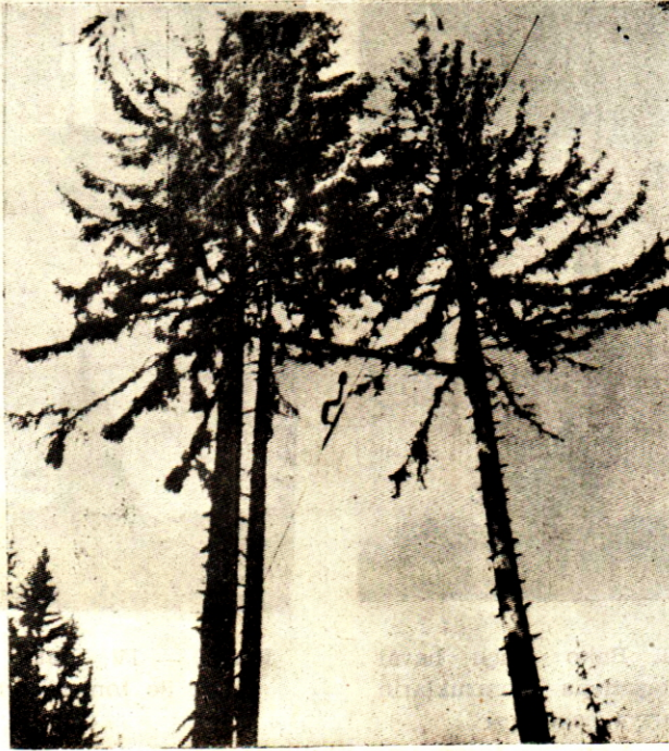
Resim —II : Bako vinçli havai hattında taşıyıcı kablunun mesned olarak seçilmiş karşılıklı iki dikili ağaca dayandırılması.
