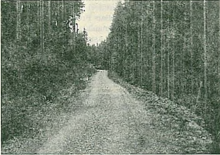
Resim 1 : İnşaatı tamamlanmış, çakıl serilmek ve silindirlemek suretiyle kaplanmış bir orman şosesi (Foto : Tavşanoğlu)
