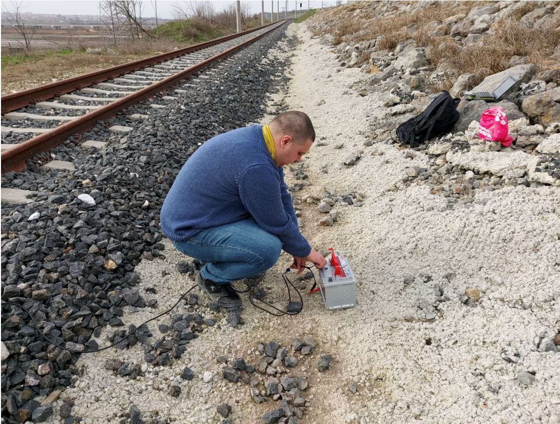
Şekil 5. Sisteme enerji verilmesi.
