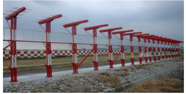
Fig. 3. ILS Localizer antenna array [5]
