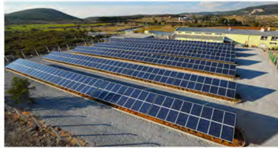
Şekil 2.5: Muğla'da lisanssız elektrik üretiminde onaylanmış ve devreye alınmış ilk güneş enerjisi santrali [6]
