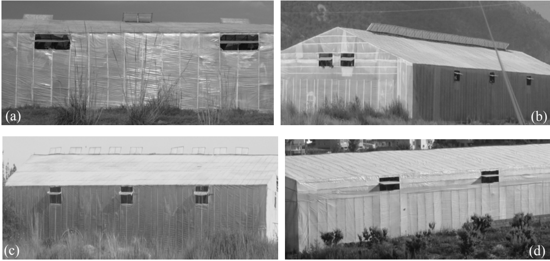
Şekil 7. İncelenen Seralarda Havalandırma Pencerelerinin Sera Yüzeyine Farklı Uygulanış Şekli
