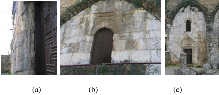
Resim 6. a. Taş yüzeylerde parça kopması, b. Yüzey kaybı, c. Aşınma, erozyon (Sevgi, 2006)
