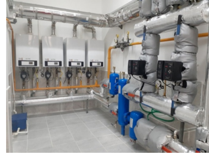
Görsel 14. Isıtma sistemi (ÇMM, 2021)
