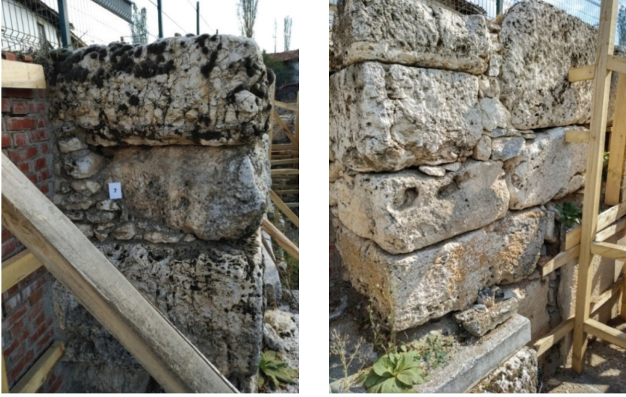
G. 12a ve G. 12b: Yapı malzemesindeki oyuklanma, çatlak ve kayıplar ile yapılan müdahaleler (Acun Özgünler, 2017).
