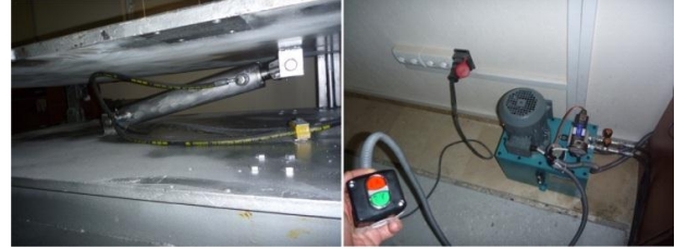
Şekil 4: Eğimlendirme pistonu ve hidrolik pompa ünitesi.
