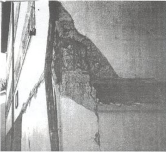
a) Pencere boşluğu ile oluşan kısa kolon etkisi
