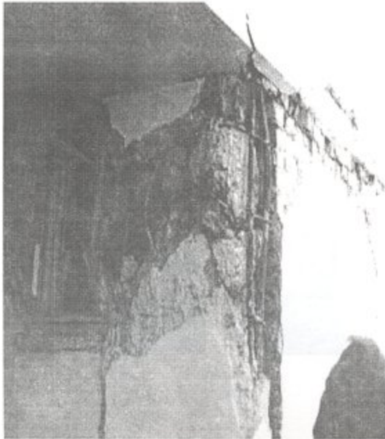
Şekil 12 Kolon sargı bölgesi hasarı
