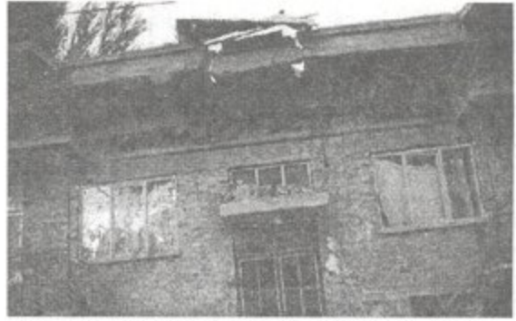
Şekil 1 Kat ilavesi yapılarak 4 katlı hale getirilmiş ve son iki katı yıkılmış olan yığma bina
