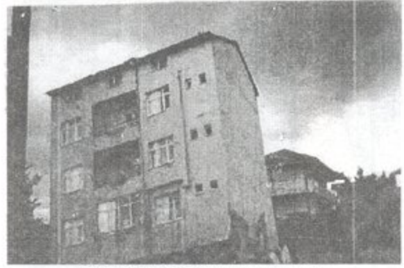
Şekil 7 Zemin katı göçmüş yapı
