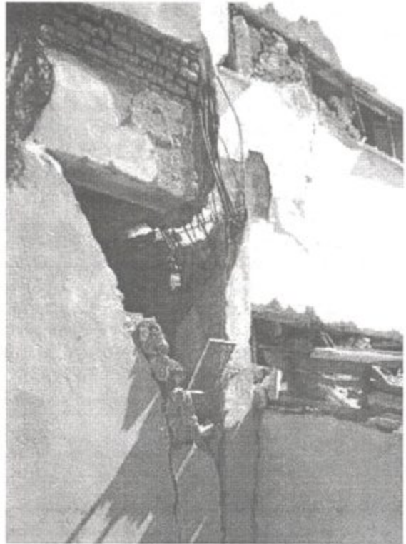
Şekil 13 Sargı yetersizliği ile hasar gören köşe kolonu
