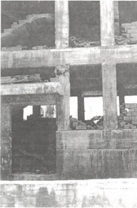
b) Merdiven kirişi ile oluşan kısa kolon etkisi
