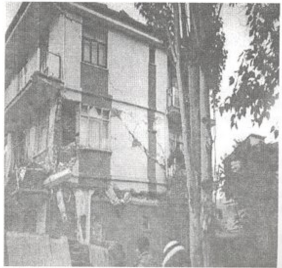
Şekil 5 Ara katı göçmüş Bodrum+4 katlı bir bina
