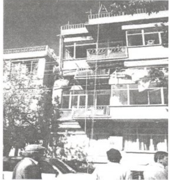
Şekil 9 Farklı yükseklikli bitişik binalarda çarpışma hasarı
