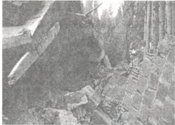
Şekil 2 Daha iskana açılmadan yerle bir olmuş dört katlı yığma bina
