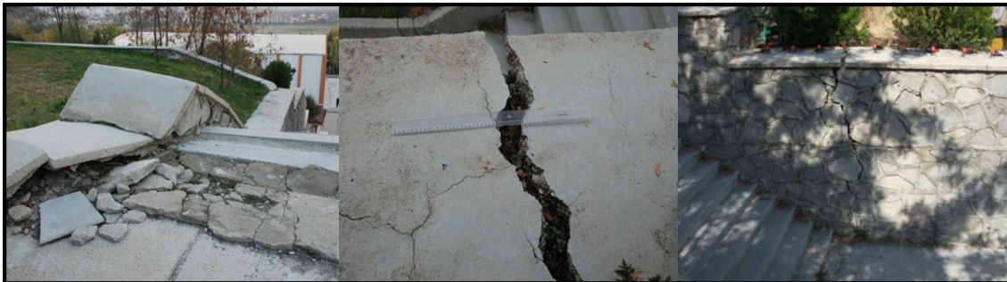
Şekil 1. İnceleme Alanında Gözlenen Çatlaklıklar (Uyanık ve Çatlıoğlu, 2013)
