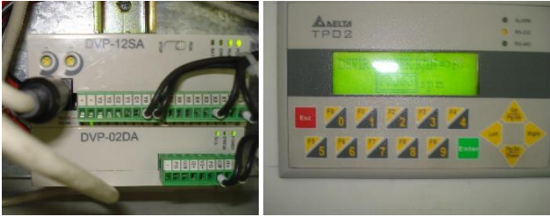
Şekil 11. PLC ve kontrol paneli
