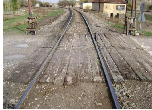
Şekil 6. Ahşap travers kaplamalı hemzemin geçit [16]
