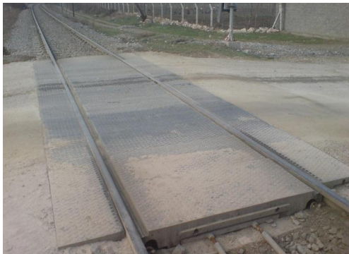
Şekil 9. Kauçuk kaplamalı hemzemin geçit [16]
