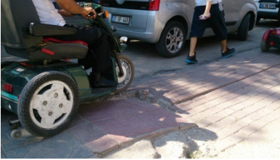
Şekil 6. C hattı üzerindeki bakımsız döşeme ve rampalar
