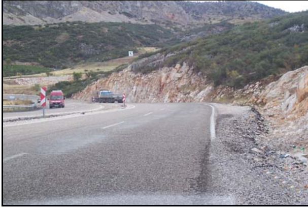
Şekil 5. Yol yapımı nedeni ile oluşan morfolojik yaralanmalar.
