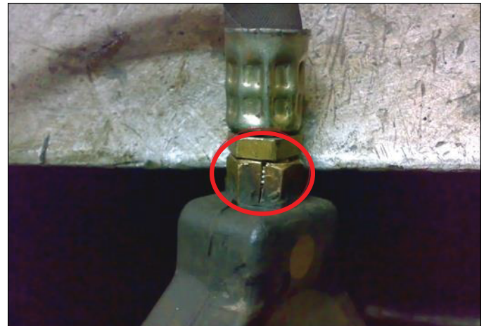
Şekil 13. Hava yastığının nipel kısmının çatlaması
