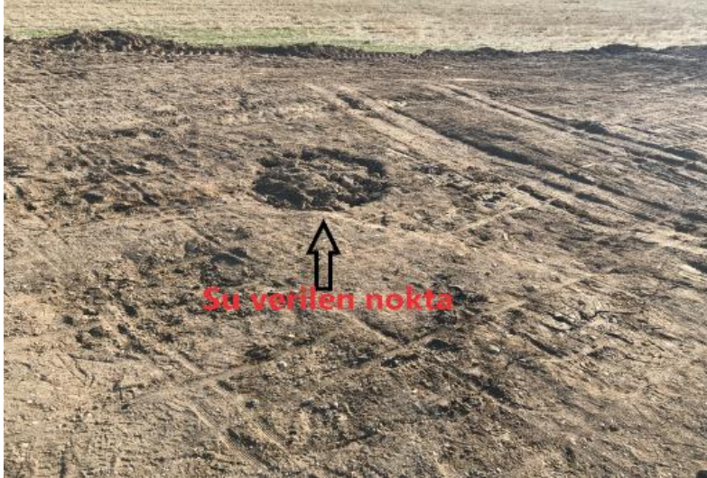
Şekil 7. Boruya su verilen nokta.
