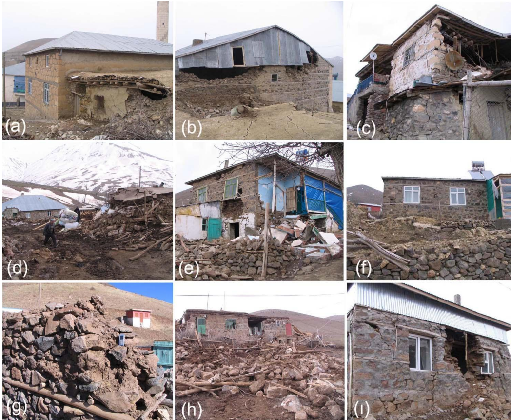
Fotoğraf 3. Kovancılar depreminde yüksek hasarın olduğu alanlardaki taş yapılar. İri taş ve beton harç kullanılan yapıların sağlam, diğerlerinin ağır hasarlı olduğu görülmüştür ((a),(b), (c) Okçular; (d), (e), (f), (g) Yukarı Demirci;(h), (i) Kayalık).
