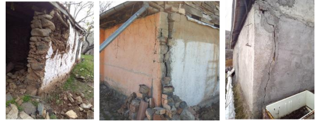
Şekil 27. Dik duvarların düzlem dışı davranışları.
