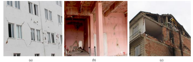
Şekil 21. Yapısal olmayan hasar örnekleri: (a) dış cephe kaplama elemanlarında dökülmeler, (b) bölme duvar çatlakları, (c) çatı hasarı.
