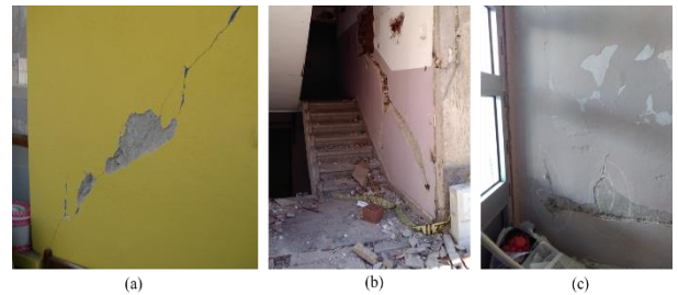
Şekil 17. Yerinde yapılan incelemelerde gözlenen perde duvar hasarı: (a) ve (b) kesme hasarı, (c) eğilme hasarı.
