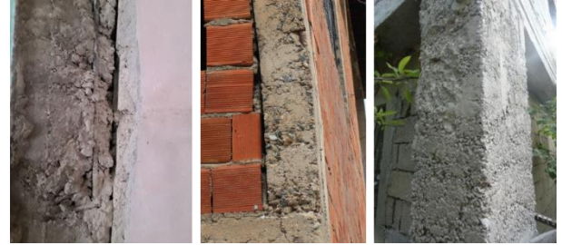
Şekil 5. Düşük dayanımlı beton kullanımı örnekleri.
