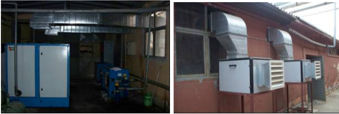
Şekil 9. Kompresörün içeriden görüntüsü ve kompresöre takılan aspiratörün dışarıdan görüntüsü
