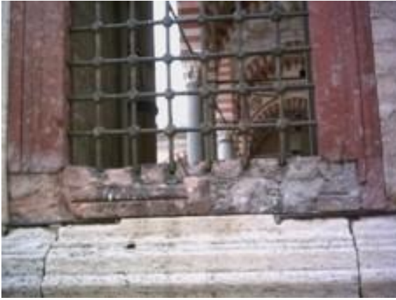
Şekil 9. Edirne Selimiye Camii Güney Cephesinde restorasyon esnasında kayacın bozuk yerinden örnek alınmıştır. Metallerin oksitlenmesi ile oluşan metal lekeleri, kabuk oluşumu ve kenedin dış cepheye bakan kısmı tamamen kopmasıyla büyük parça kayıpları görülmektedir.
