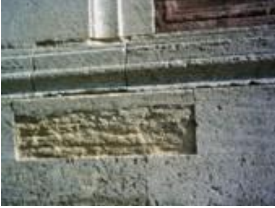
Şekil 4. Edirne Selimiye Camii Batı Cephesinde restorasyon esnasında kayacın bozuk yerinden örnek alınmıştır. Kayaçta yüzeysel erozyon görülmektedir.
