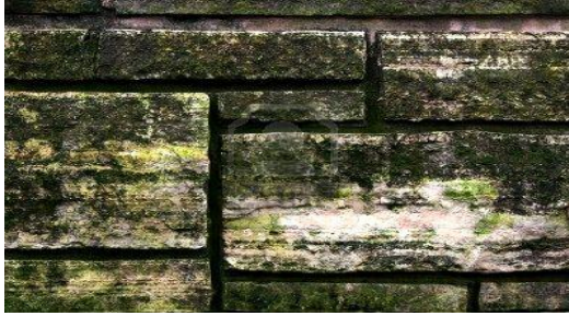
Şekil 7. Mantarların taş duvar yüzeyinde sebep olduğu renk değiştirmeleri ve kararmalar şeklinde görülen mantar alterasyonları (Web-4).
