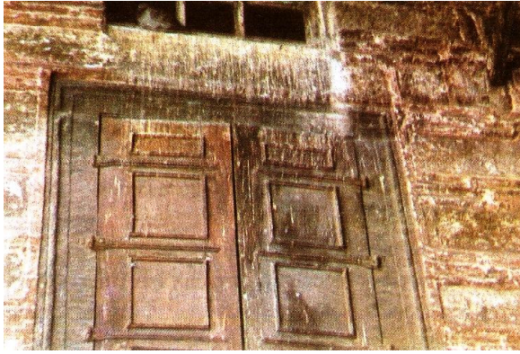
Şekil 11. İstanbul/Yeni Cami/Hünkar Kasrı cephesinde güvercin dışkılarının neden olduğu kirlilik, taş çözünmeleri ve bozunma şeklinde görülen alterasyonlar (Küçükaya, 2004).
