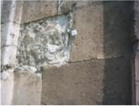
Şekil 5. Edirne Üç Şerefeli Camii Güney Cephesinde restorasyon esnasında kayacın bozuk yerinden örnek alınmıştır. Yapı taşlarında kimyasal çözünme ile yüzeysel erozyon oluşmuştur.
