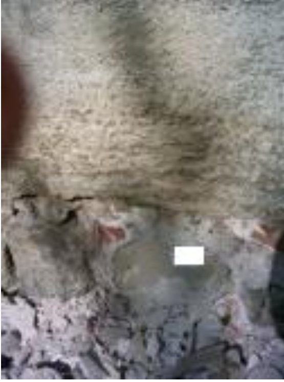
Şekil 6. Edirne Selimiye Camii Müze duvarından restorasyon esnasında kayacın bozuk yerinden örnek alınmıştır. Yapı taşlarında tuzun kirli katmanlar üzerinde yarattığı çözünmeler.
