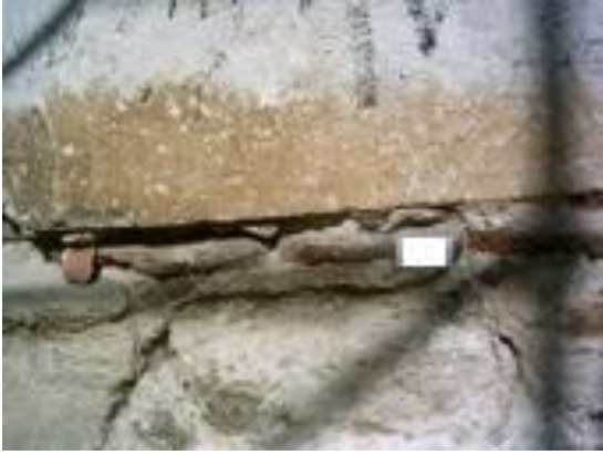
Şekil 7. Edirne Selimiye Camii Müze duvarından restorasyon esnasında kayacın bozuk yerinden örnek alınmıştır. Yapı taşlarına harç ve tuğla bünyesindeki tuzların neden olduğu kayacın renk değişimi ve lekelenmeler şeklindeki alterasyonlar.
