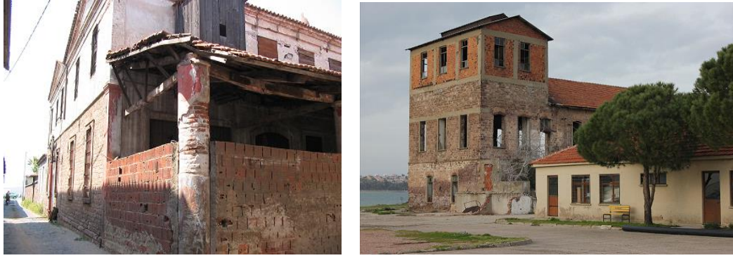
Şekil 9. Ayvalıkta Zeytinyağı Fabrikası ve Sabunhanesi olarak inşa edilmiş fabrika binalarındaki bozulma örnekleri (Kabasakal, 2004 ve Uçar, 2013)
