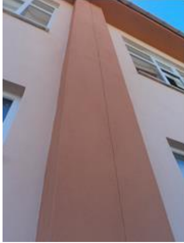
a) Bina dış cephe dilatasyon noktası
