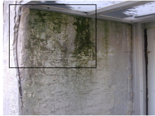
Şekil 3.20: Binanın dış kısmında yosunlanma
