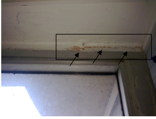
Şekil 3.15: Pencere kenarında korozyon
