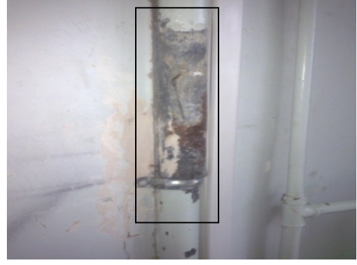
Şekil 3.16: Kalorifer tesisatında korozyon
