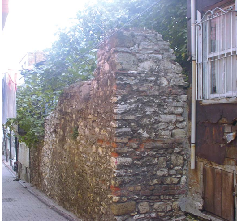
Resim 19: Mescitten geriye kalan duvar
