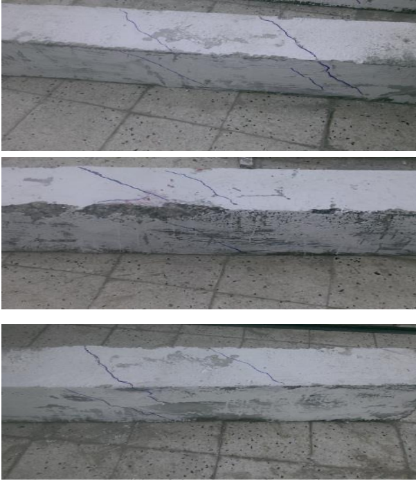
Şekil 6. KYB serilerinde meydana gelen çatlaklar
