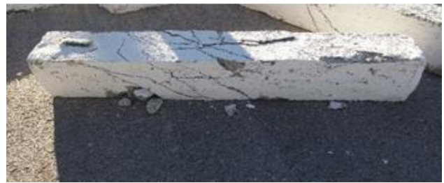
Şekil 5. Normal beton serilerinde meydana gelen çatlaklar
