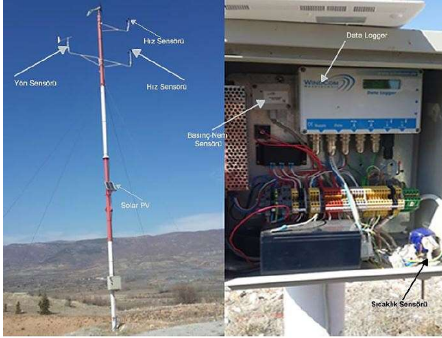
Şekil 1. Rüzgar Ölçüm İstasyonu Figure 1. Wind Measurement Station
