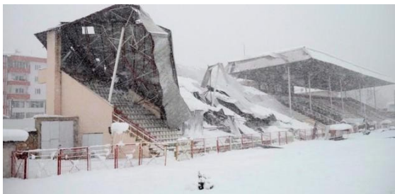
Şekil 3. Kar yükünden dolayı çökmüş stadyum çatısı
