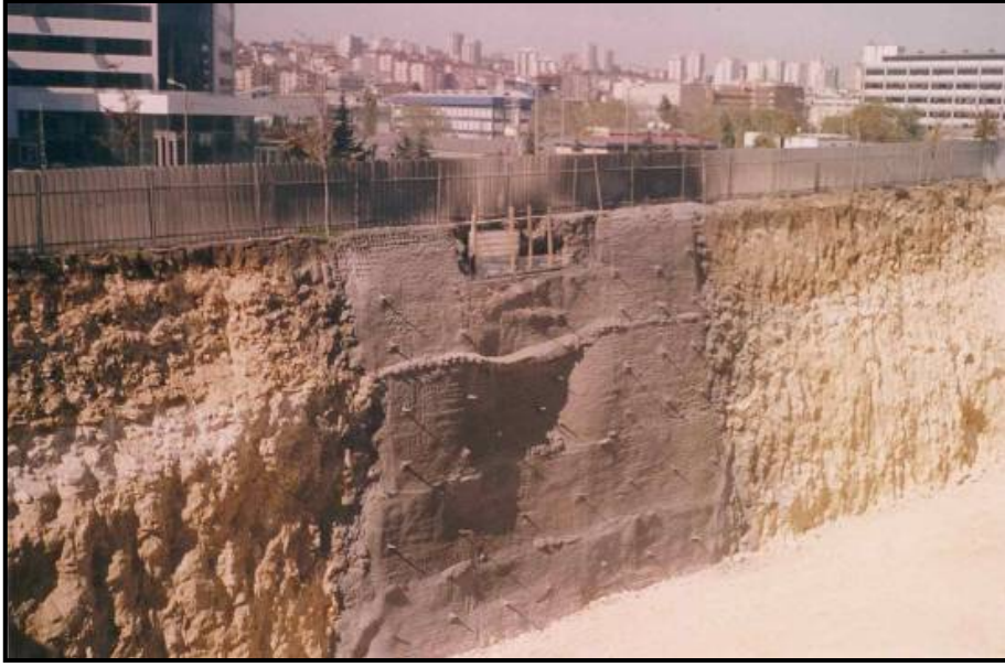
Şekil 13. Basın ekspres yolu yakınındaki Kırklareli formasyonunda karstik boşluğun ek önlemler alınarak iyileştirilmesi
