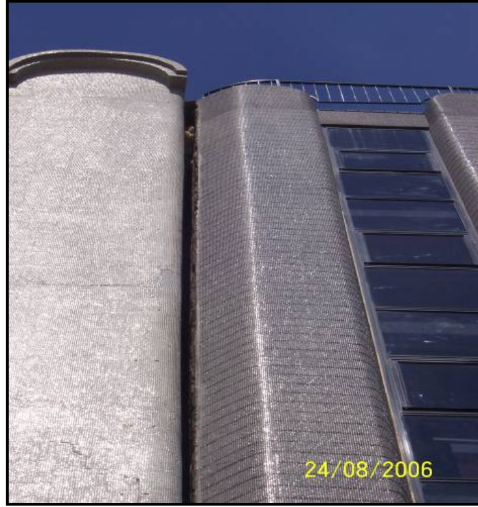
Şekil 16. Komşu parselde temel kazısı sonucu meydana gelen deformasyon Figure 16. Deformation in the foundation excavation in the neighbouring parcel
