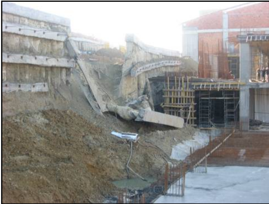
Şekil 17. Esenyurt dolayında kazık projesinin yetersiz olması dolayısıyla oluşan kazık yenilmesi Figure 17. The pile project being insufficient to cause defeated piles, in Esenyurt
