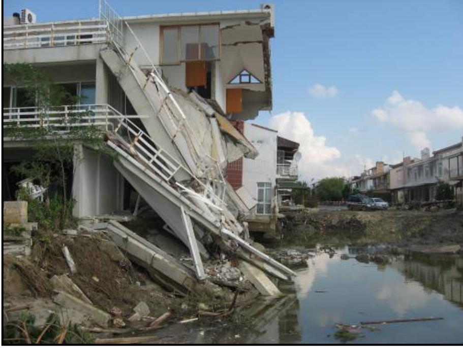
Şekil 5. Selimpaşa da bina temelinin sel dolayısıyla boşalması sonucu oluşan yıkılma Figure 5. Foundations collapse due to flood discharge in Selimpaşa
