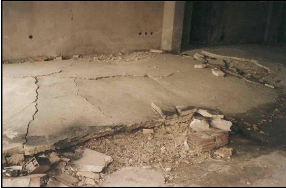
Şekil 10. Bina temelinde taşıma gücünün aşılmasından dolayı gelişen taban kabarması Figure 10. Bearing capacity of the building exceeded due to growing base heave
