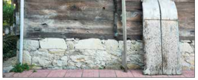
Fotoğraf 9. Güney cephede moloz taş örgü / Rubble stone masonry on the southern facade.
