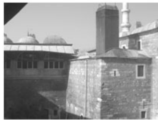
Şekil 38. Rüstempaşa Kervansarayı, Küçük Han Bölümündeki ısıtma merkezi bacası (Orijinal,2006)
