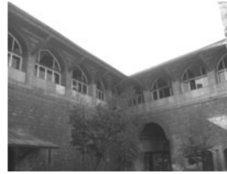
Şekil 36. Rüstempaşa Kervansarayı, Küçük Han bölümündeki galerinin cemekânla Kapatılması (Orijinal,2006)
