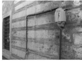
Şekil 32. Defterdar Mustafa Paşa Camii yan cephesindeki elektrik donanımı (Orijinal, 2006)
