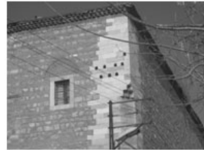
Şekil 40. Rüstempaşa Kervansarayı Arka cephesine yama şeklinde yapılmış onarım (Orijinal,2006)
