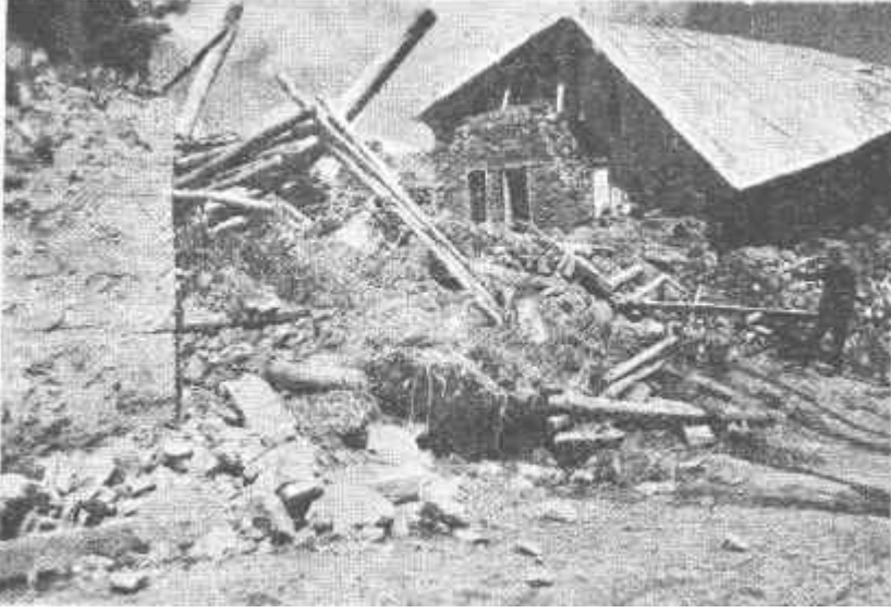
Resim 5 — Akpınar köyünde depremden harab olan okut. Oluklu saçdan ibaret dam, ağaçtan bir iskeleti olan kerpiç binanın üstünde, duvarın yıkılması sonucu bu hale gelmiştir. Bina toprak ve düz damlı olsaydı netice başka türlü olurdu. (Foto : C. Alagöz)
