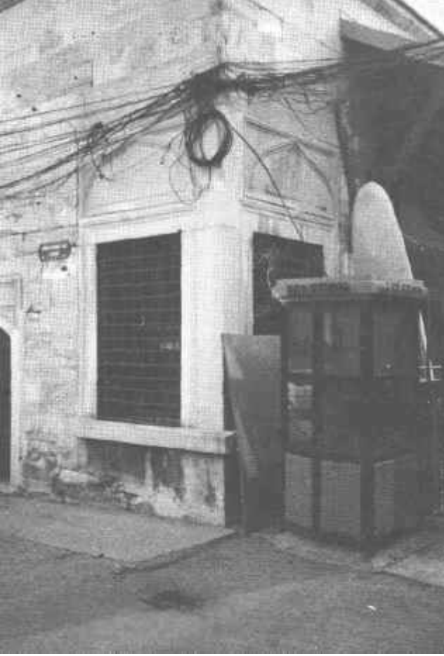
Resim. 9. Sultanahmet Arasta Sebili. Sebil penceresi üzerindeki telefon kabloları ve pencere önüne konula telefon kulübesi görülüyor.
