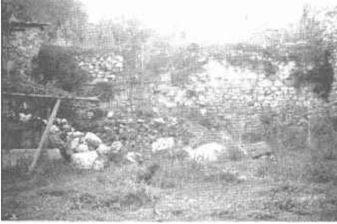
Resim: 2. Balabaniye Medresesinden geriye kalan güneybatı duvarının harap hâli.
