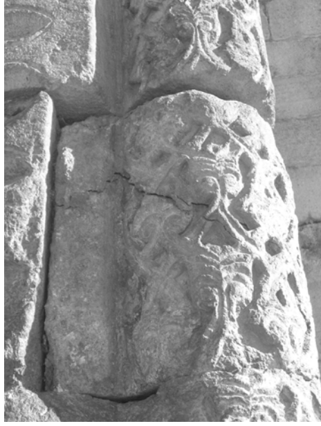
Resim 8. Erzurum Yakutiye Medresesi, portaldeki köşe sütuncesinde çatlak.
