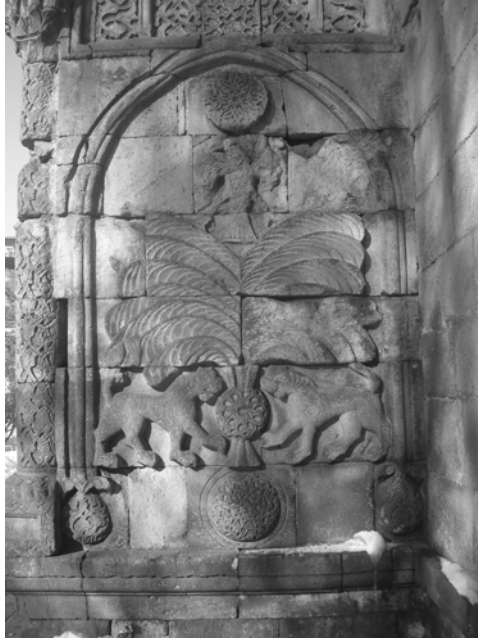
Resim 9. Erzurum Yakutiye Medresesi, portal sağ yan kanadında aşınmadan kaynaklanan bozulma.
