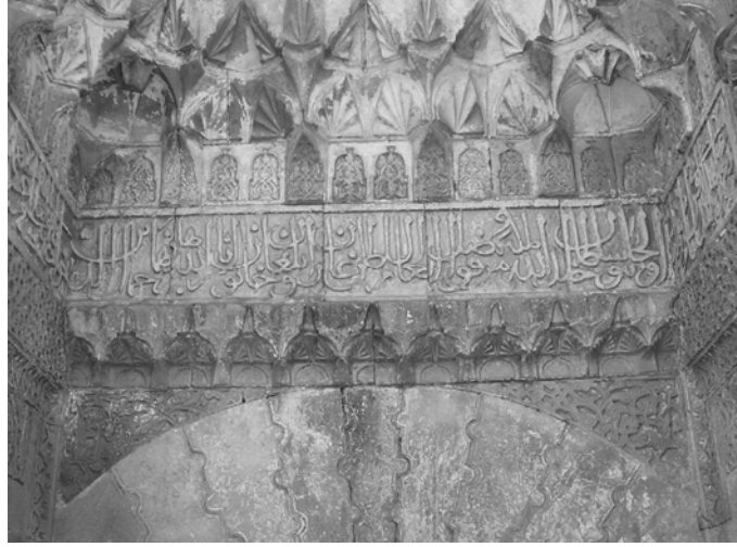
Resim 12. Erzurum Yakutiye Medresesi, portal nişinde özgün olmayan boya kalıntılarında kaynaklanan kirlenme.
