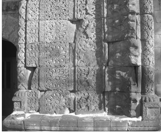
Resim 5. Erzurum Yakutiye Medresesi, portal sağ kanadındaki kenetlerden bazıları ve bunların yol açtığı bozulmalar.
