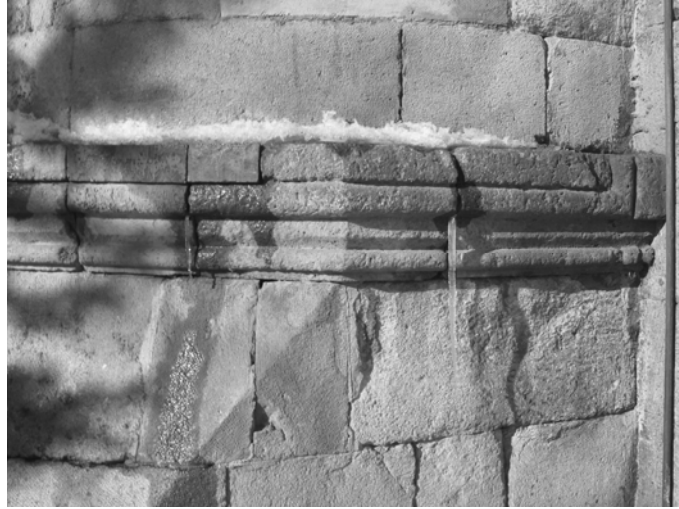
Resim 13. Erzurum Yakutiye Medresesi, minare kaidesinde derz boşalması.
