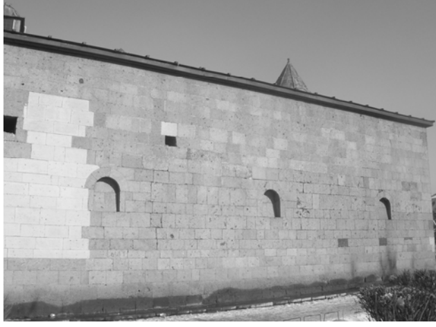
Resim 14. Erzurum Yakutiye Medresesi, gney cephe duvar dibinde drenaj ve atı sisteminden kaynaklanan bozulma.
