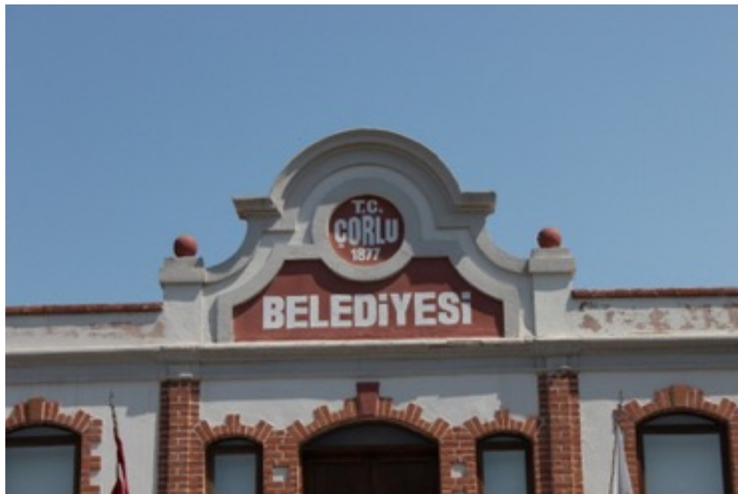
Foto. 7: Çorlu belediye binası güneybatı cephe merkezinde yer alan iç ve dış bükey hatlara sahip alınlık (E. Kolay)
